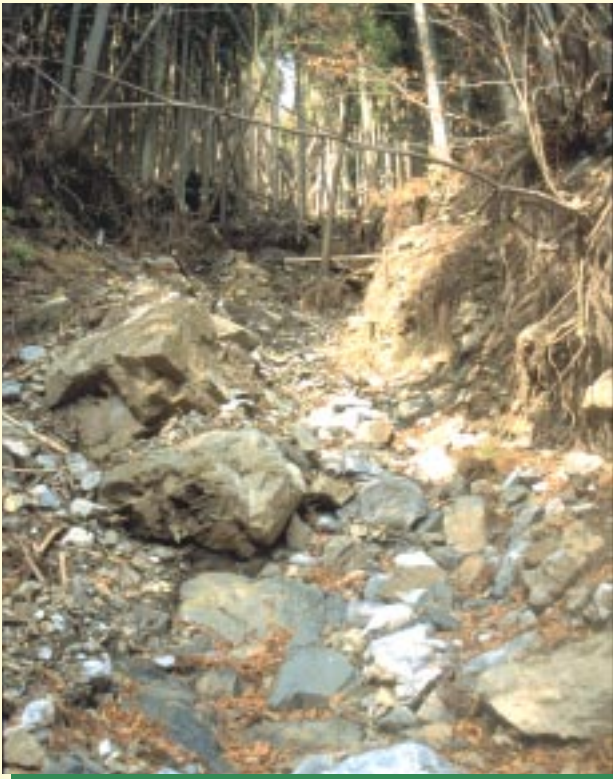
崩れていく山
